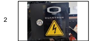
2 Caja de conexión cable de carga
